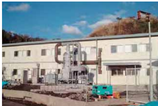
宿舍に設置された脱硫装置
