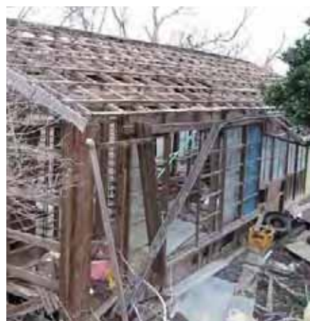
火山ガスの影響で屋根がなくなった家
