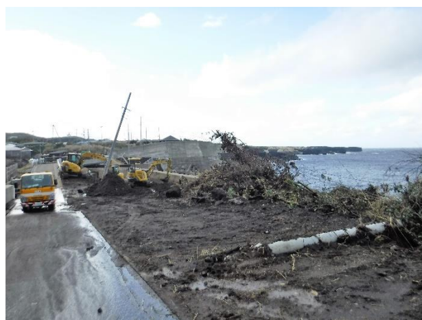
倒壊した電柱
