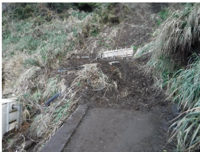
源泉設備周辺
