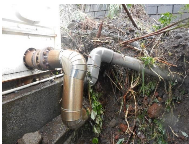
貯湯タンクからポンプ小屋までの配管
