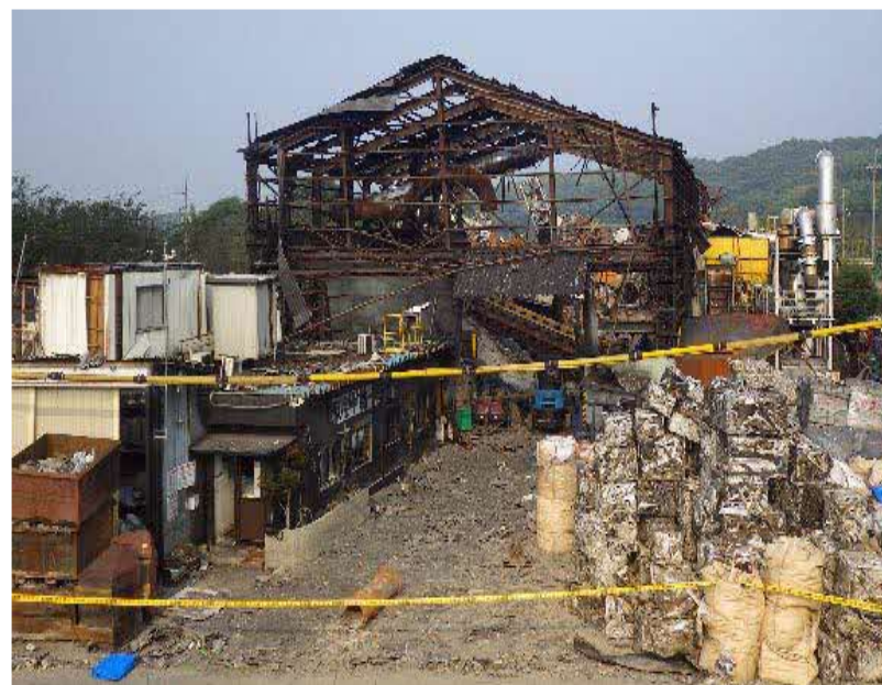
アルミ工場の火災事故の状況
