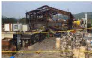
写真② アルミ工場の火災事故の状況
